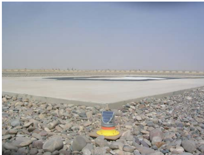
AV70 heliport edge light, Iraq
